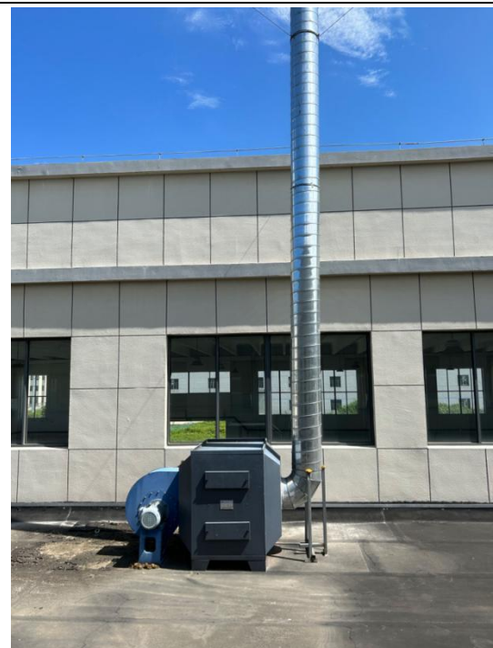
注塑废气处理装置
