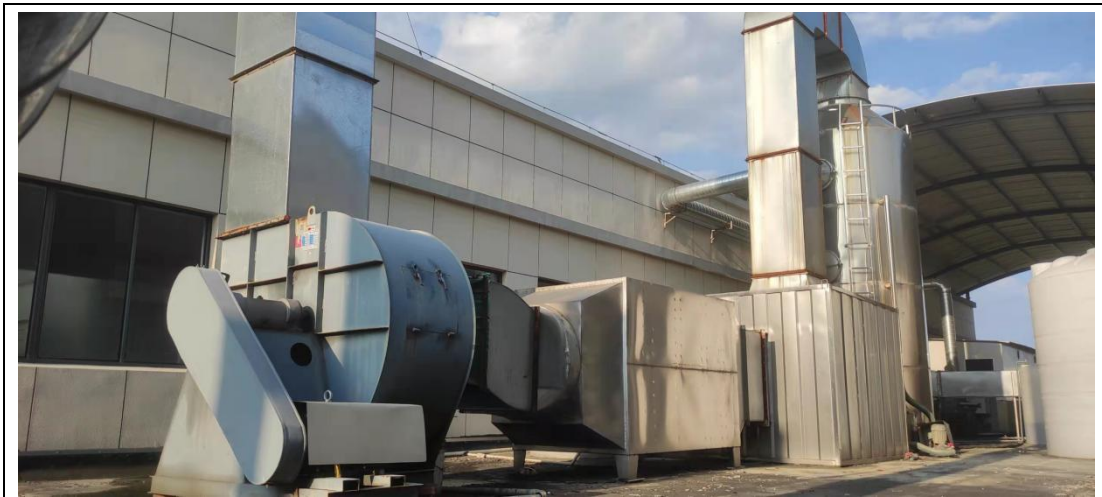
有机废气处理装置
